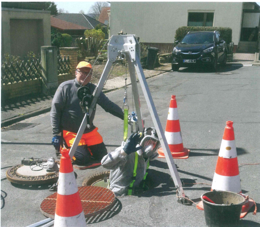
„Schacht Completed“ bringt Vorteile für Dienstleister, Auftraggeber und Verkehrsteilnehmer mit sich. | Fotos: N. Thieltges GmbH & Co. KG
