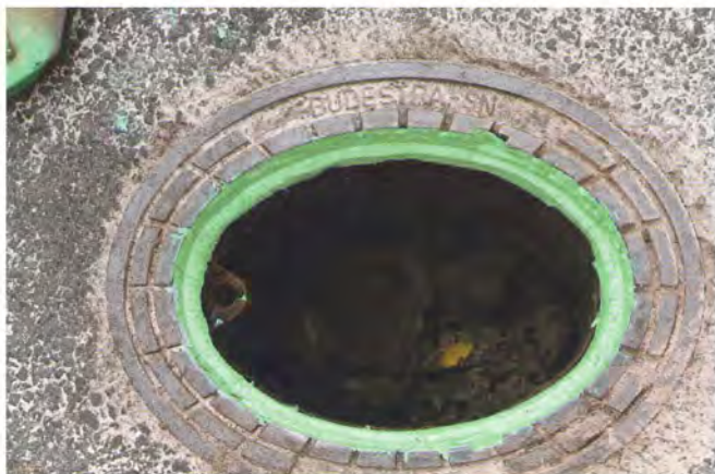
2: Mit dem dauerflexiblen Epoxidharz-System „Flüsterkappe“ wird die Hydrantenkappe wieder auf Fahrbahnniveau gebracht, ....
