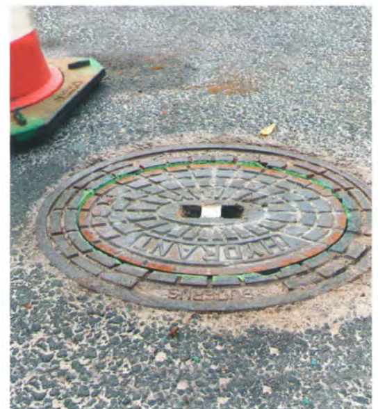
Der Deckel wird wieder auf Straßenniveau eingesetzt. Die Reparatur mit dem Flüsterkappen-Set geht schnell und einfach. | Fotos: resinnovation
