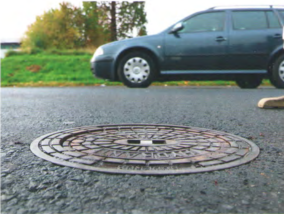
Straßenkappen sind tagtäglich den Belastungen durch darüberfahrende Pkw, Lkw und Busse ausgesetzt. Die Folge sind oft eingefahrene Deckel, die nicht mehr auf Fahrhahnniveau liegen.
